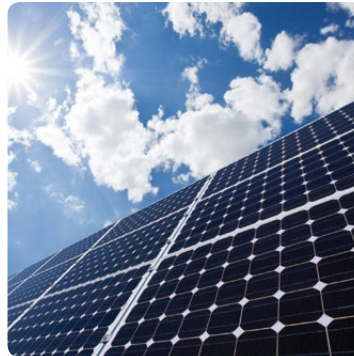
Energiegewinnung durch Photovoltaik bei EVVA
